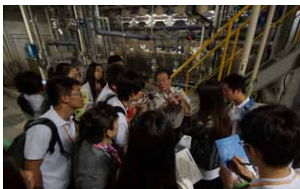
新大谷酒店 参观地下中水制造成套设备净化厨房废水的过程。
